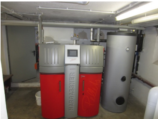
Abbildung 10: neu eingebaute Heizung
